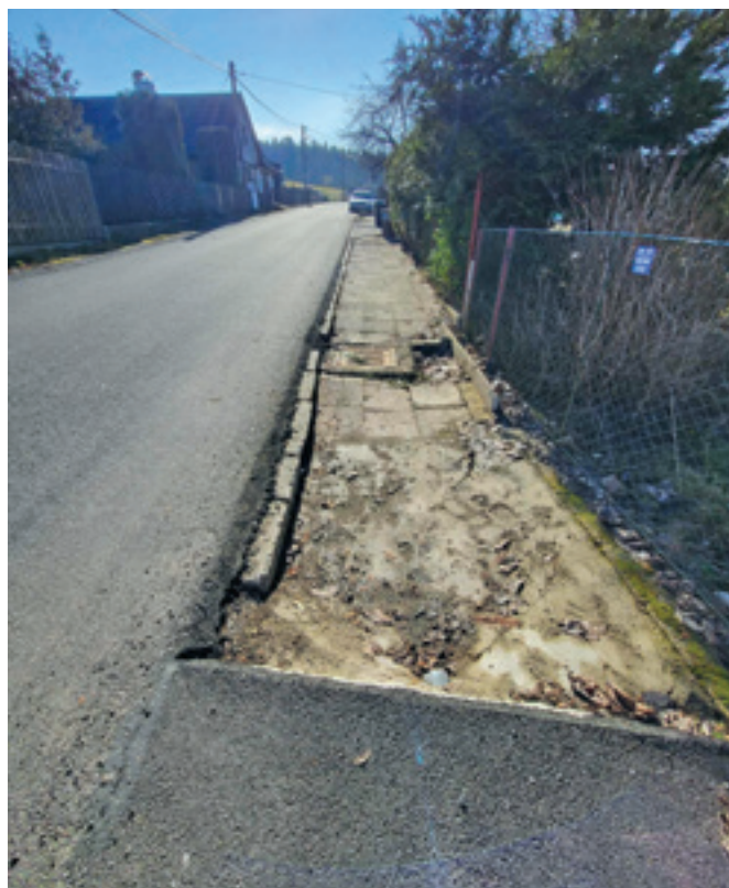
Druhá část chodníku na Kvani – čekající na renovaci
